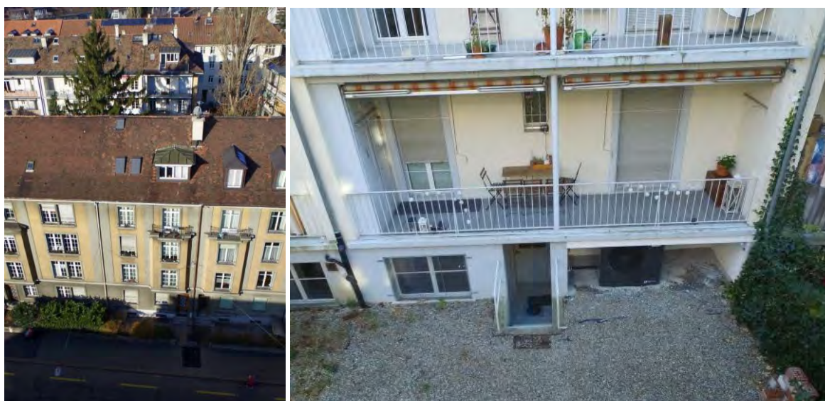
Abbildung 32: Eingebautes Reihen- Mehrfamilienhaus «Baumgartnerhaus» in Basel; aussenaufgestellte Wärmepumpe unter dem Erdgeschossbalkon. Quelle: Frei & Partner AG, Zwingen
