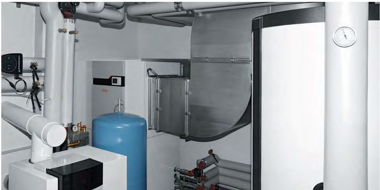
Abbildung 31: Innenaufgestellte Wärmepumpe zwischen Gas-Brennwertkessel und Speicher. Quelle: Elcotherm AG.
