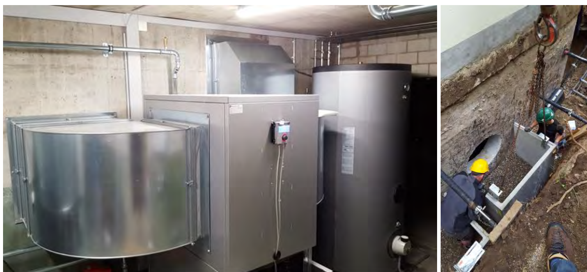
Abbildung 17: Links Innenaufgestellte Anlage im ehem. Tankraum; rechts Setzen der Lichtschächte am bestehenden Objekt. Quelle: Frei & Partner AG, Zwingen
