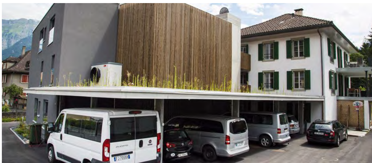
Abbildung 22: Aussenaufgestellte Wärmepumpe auf dem Carport-Flachdach. Quelle: Hoval.
