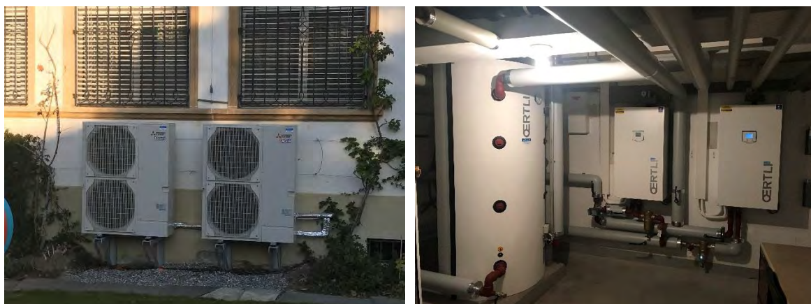
Abbildung 9: Links: Ausseneinheit, rechts Inneneinheit. Quelle: Schwab Heizung Sanitär Klima AG, Kerzers
