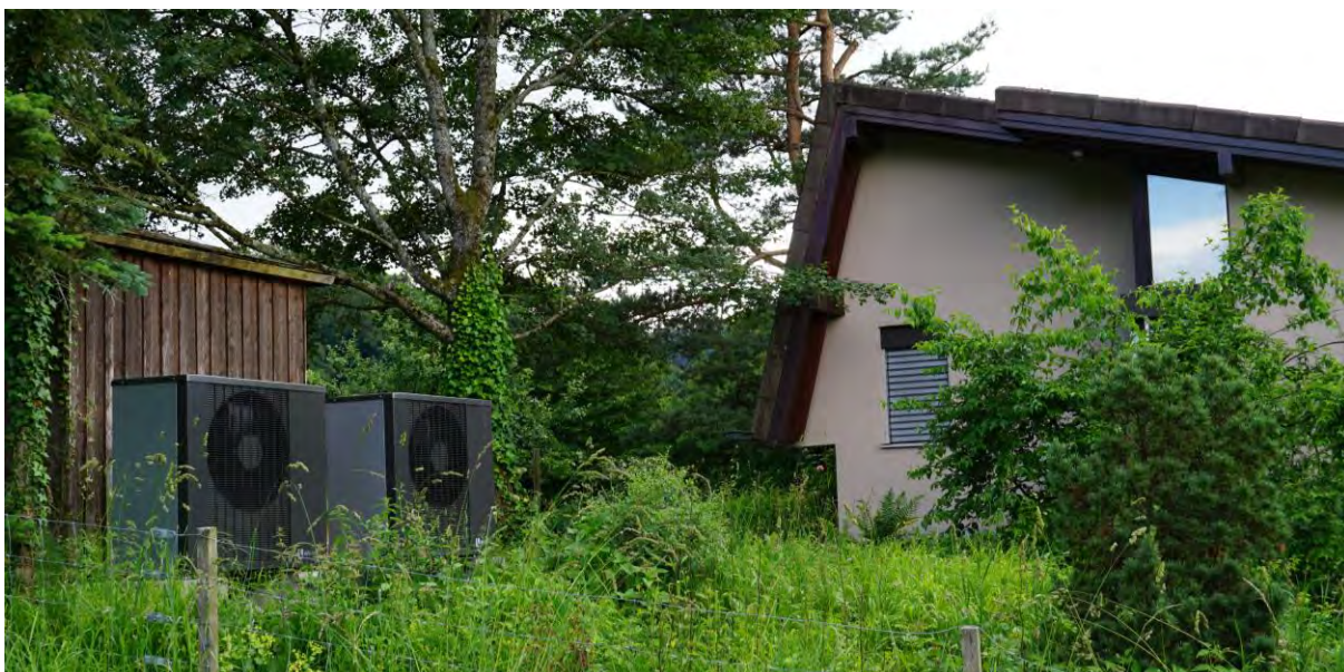
Abbildung 26: Aussenaufgestellte Wärmepumpen im Garten. Quelle: Frei & Partner AG, Zwingen
