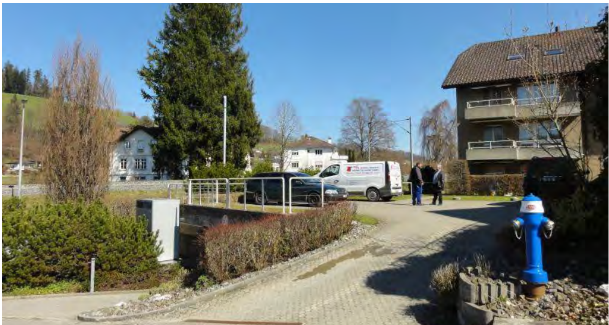
Abbildung 6: Aussenaufgestellte Wärmepumpe, «versteckt» neben der Tiefgarageneinfahrt, mit der Liegenschaft im Hintergrund. Quelle: Märki, Bucher & Perch-Nielsen (2018).
