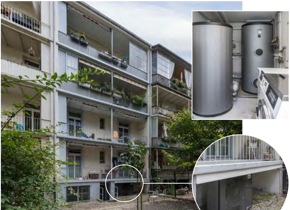
Aussen aufgestellte Wärmepumpe unter dem von unten gedämmtem Erdgeschossbalkon.
