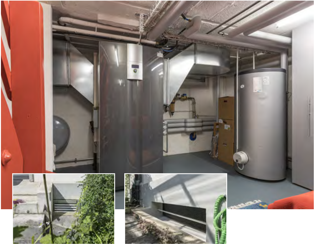
Wärmepumpe im Keller, Ansaugöffnung neben dem Eingang (links), Ausblasen durch Kellerfenster (rechts).
