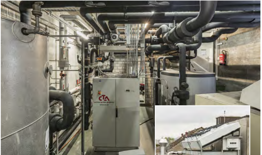
Wärmepumpe und Speicher im dritten Untergeschoss, Rückkühler auf dem Dach
